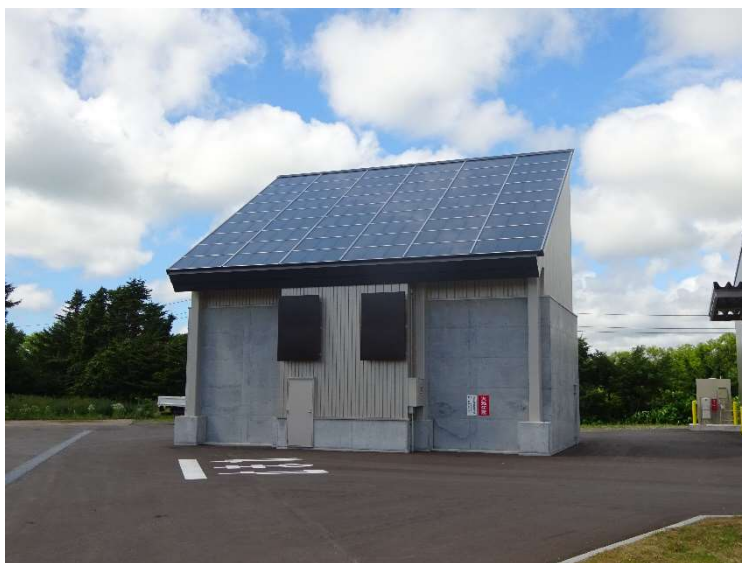
西天北サーマルリサイクルファクトリー内 木質チップ乾燥設備
