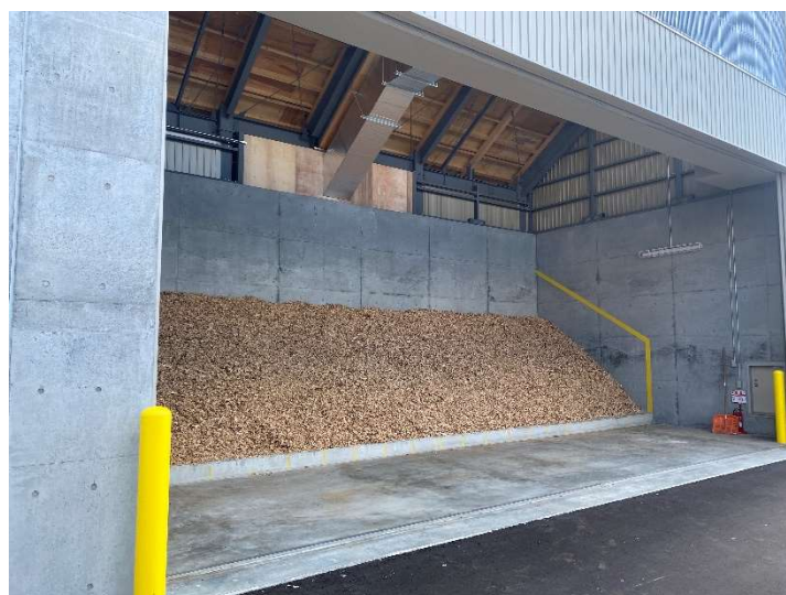
木質チップ充填状況（試運転時）
